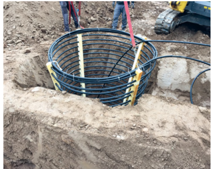
Vier Erdwärmekörbe Maxi von BetaTherm in 3,90 m Tiefe liefern Wärme für die Wärmepumpe in der kalten Jahreszeit. Foto: PA-ID Process
