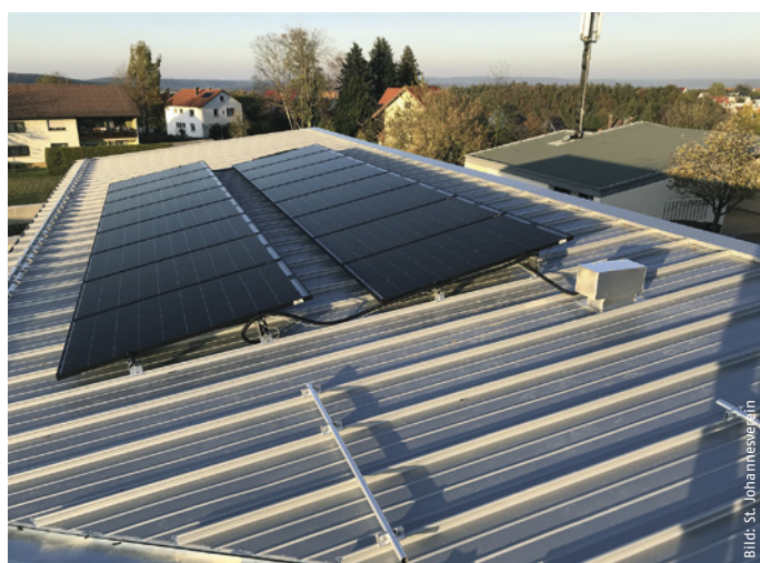
Bild 3: 16 von 32 PVT-Kollektoren auf dem Dach der Seniorentagesstätte Johannesberg.
