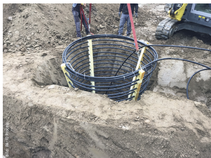
Bild 4: Der Erdwärmekorb „Maxi“ von BetaTherm wurde 3,90 m tief im Erdreich versenkt. Insgesamt liefern vier Erdkörbe Wärme für die Wärmepumpe in der kalten Jahreszeit.
