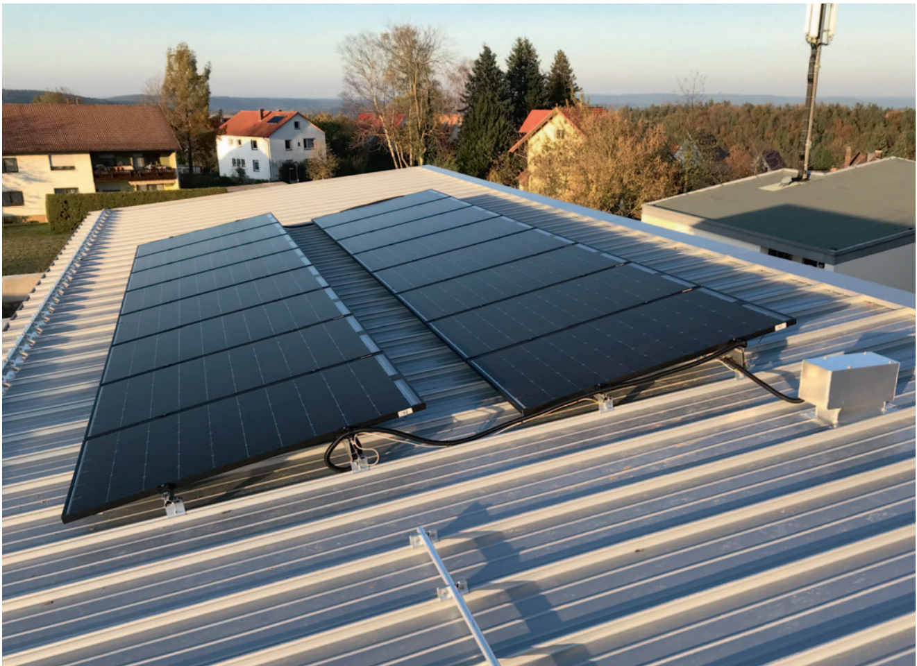
16 von 32 PVT-Kollektoren auf dem Dach der Seniorentagesstätte in Johannesberg bei Aschaffenburg.
