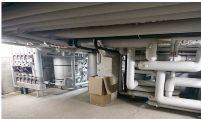
In der Heizzentrale stehen Speicher, ein Pellet- und ein Gas-Brennwertkessel. Sie werden ergänzt durch drei Luft-Wärmepumpen und ein BHKW. Das BHKW liegt aus Schallschutzgründen in einem separaten Raum. Foto: Bernhard Knierim
